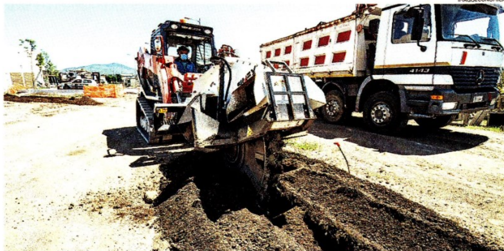
In cantiere. I rincari hanno riguardato non solo l'acciaio, ma anche materiali fondamentali come i polietilene, il rame e il petrolio
