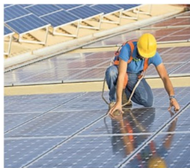
▲ Energia Un impianto fotovoltaico
