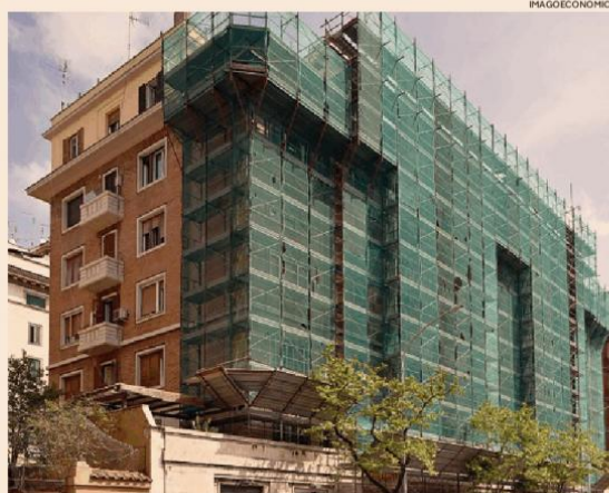
Lavori in corso. Il restauro della facciata di un condominio a Roma
