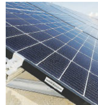
SOLE Pannelli fotovoltaici
