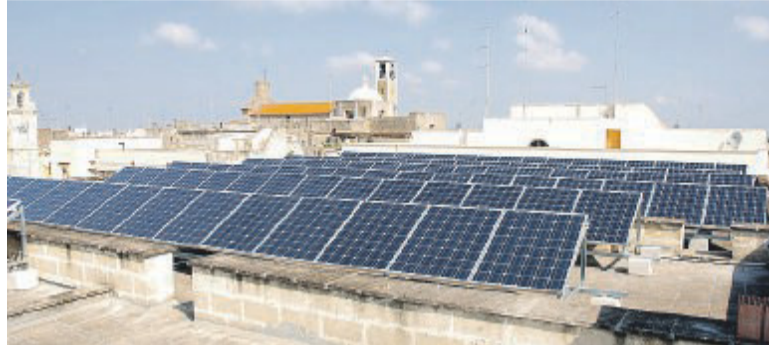
PANNELLI SOLARI Un impianto installato nella città di Leverano
