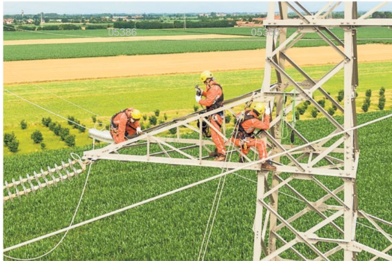
▲ La rete I tralici per il trasporto dell'energia elettrica gestiti da Terna spa
