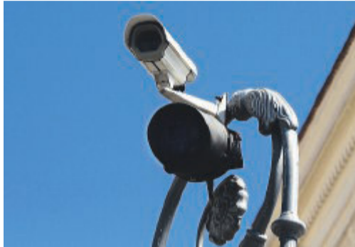
Impianto di videosorveglianza
