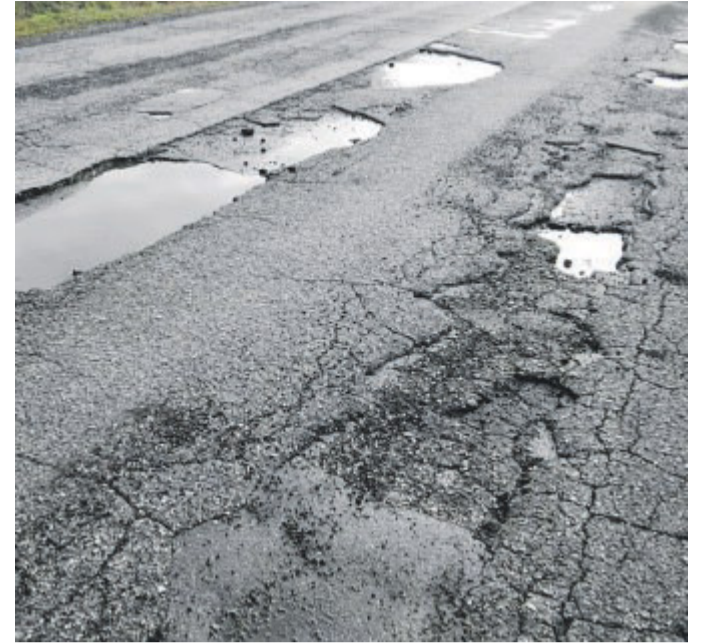
Le buche e l'asfalto sconnesso sulla Foggia Cerignola
