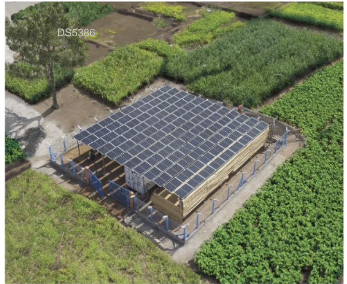
UN IMPIANTO DI DESALINIZZAZIONE CONTAINERIZZATO CON FOTOVOLTAICO
