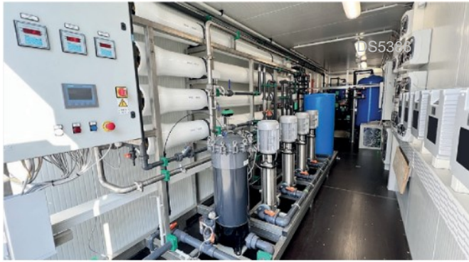
IL DESALINIZZATORE DI ACQUA POSTO ALL'INTERNO DEL CONTAINER
