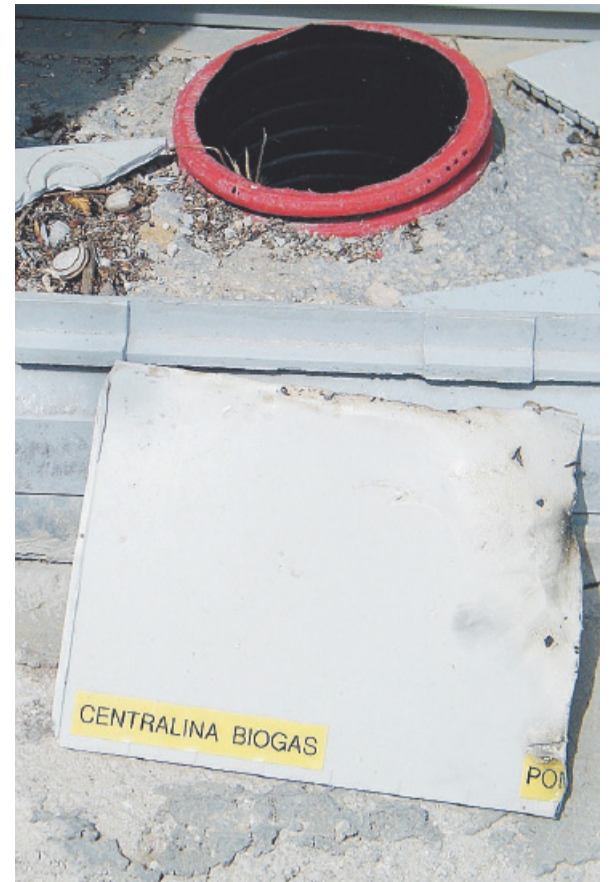
Una centralina di impianto biogas
