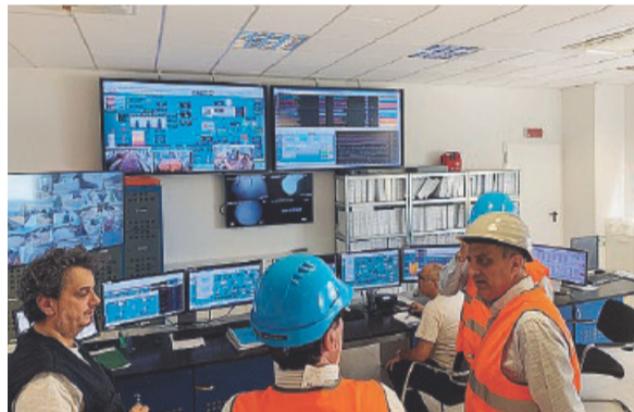
La centrale di controllo della Agritre a Sant'Agata di Puglia
