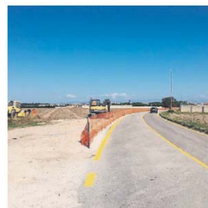
APRE IL CANTIERE A sinistra i lavori per la costruzione del raccordo, a destra il progetto per il prolungamento della pista in via Castelluccio
